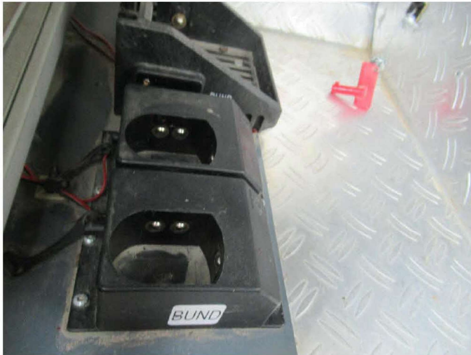
Bild 15 : zeigt die überfluteten Ladegeräte
