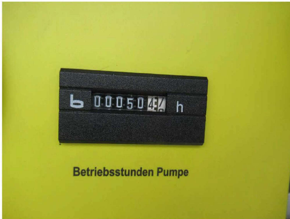
Bild 9 : zeigt die Pumpenstundenanzeige
