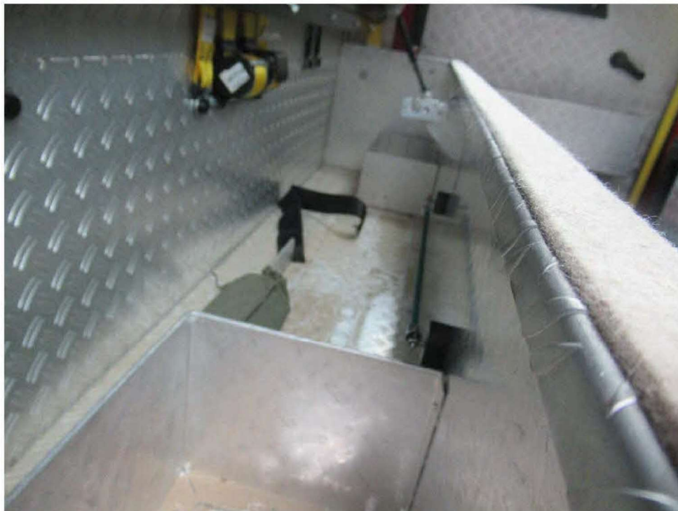
Bild 12 : zeigt die Schlammablagerungen im Ladebereich
