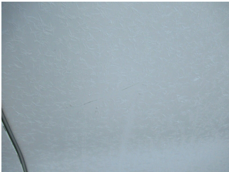
Bild 10 : Seitenwand hl Kratzer
