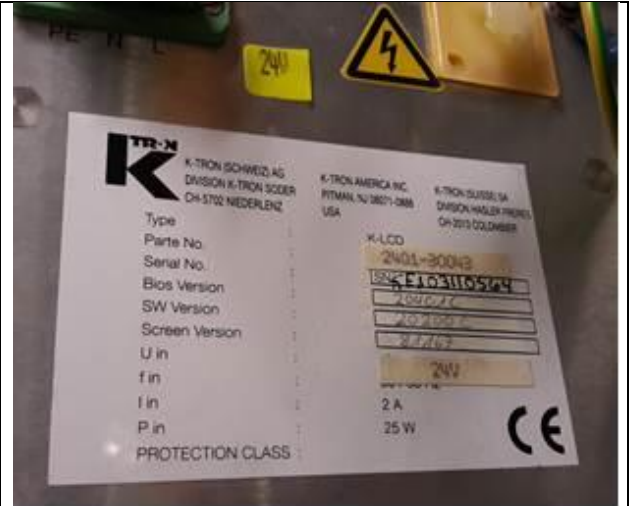
Steuerung Schaltschrank Typenschild
